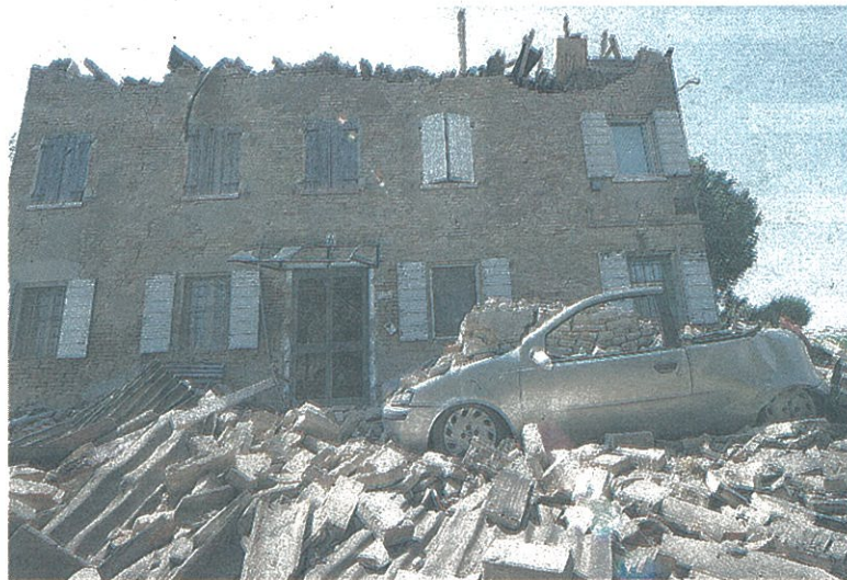
TERREMOTO Un'abitazione di Mirandola gravemente danneggiata dal sisma del 29 maggio scorso
